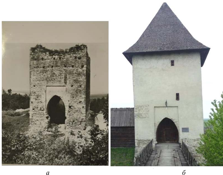
Рис. 2. Загальний вигляд південної фронтальної стіни вежі а – до проведення реставраційних робіт (за [5]); б – та після реставрації.
